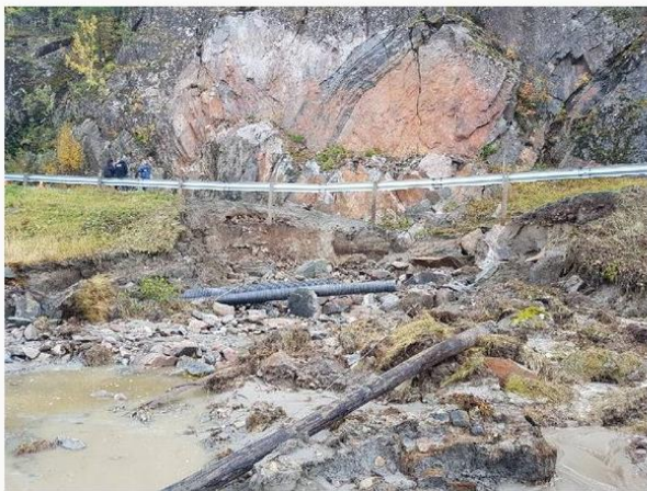
340 eiendommer ble isolert etter ras ved Leirvika i Snillfjord søndag. FOTO: MARITA BYBERG JOHANSEN
