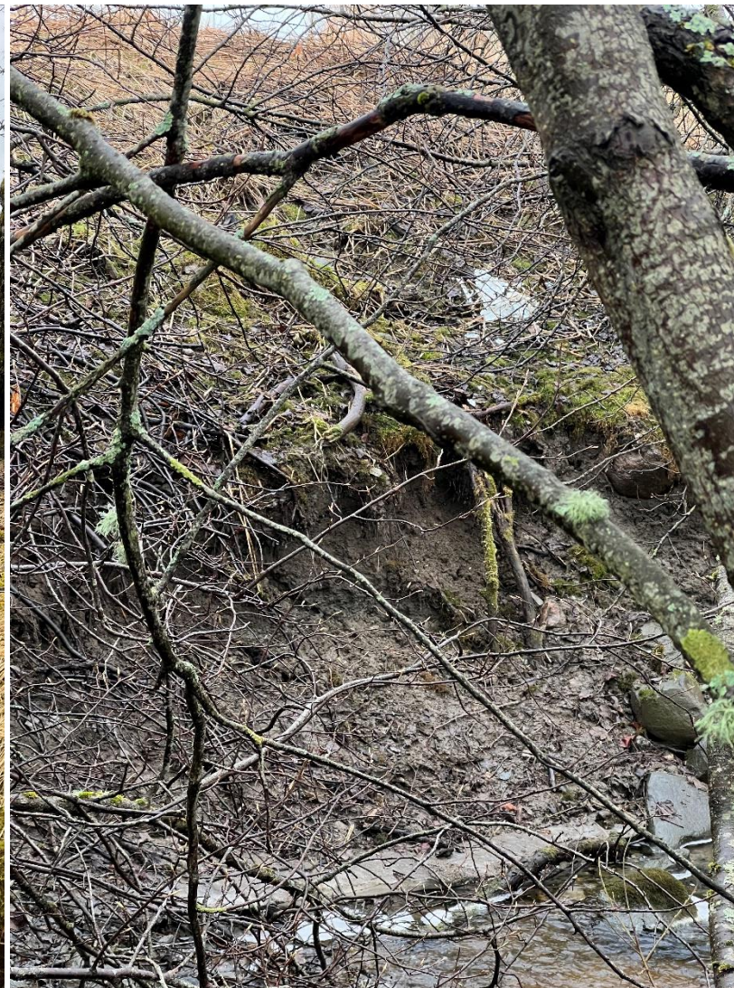
Erosjon av lett eroderbare masser
