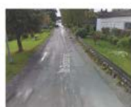
Ferdsl i kjørebanelen
