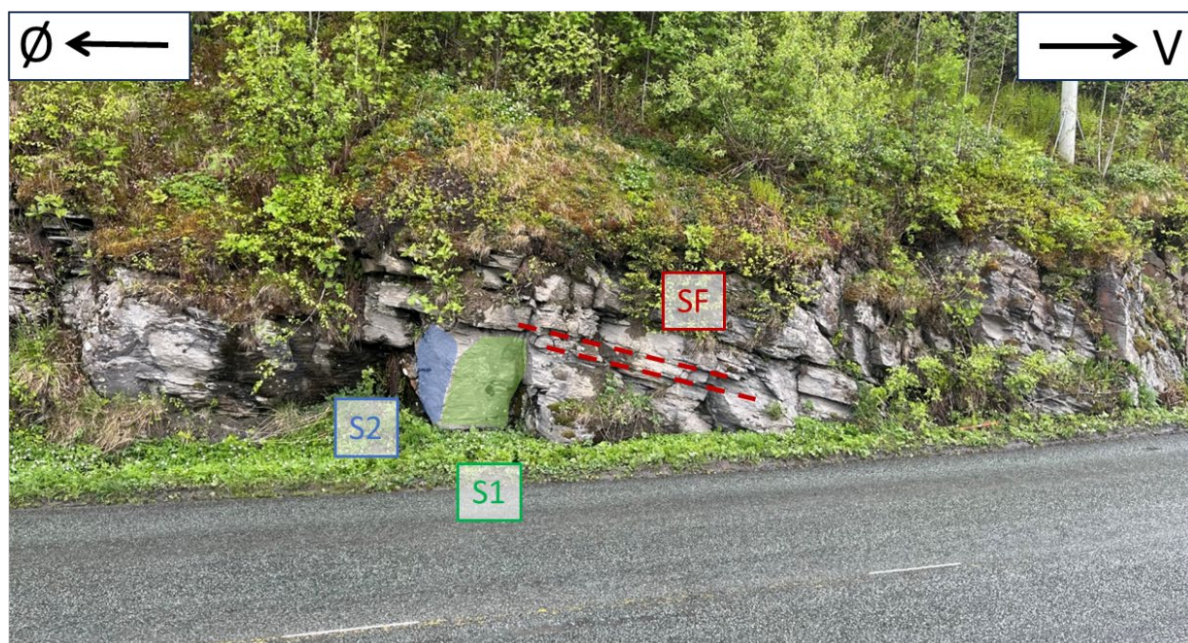
Figur 6: Oppsprekking i eksisterende bergskjæring omkring profilnr. 950. Bilde tatt mot sør.
