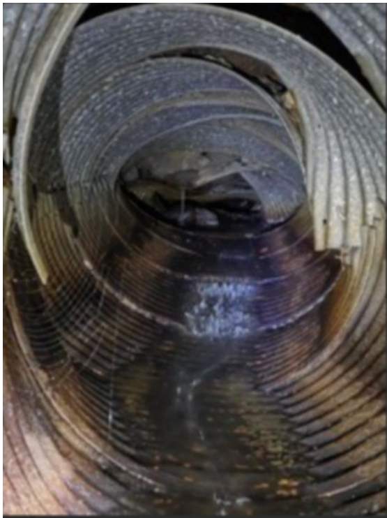
Figur 26: Kollapset stikkrenne Rossmobekken
