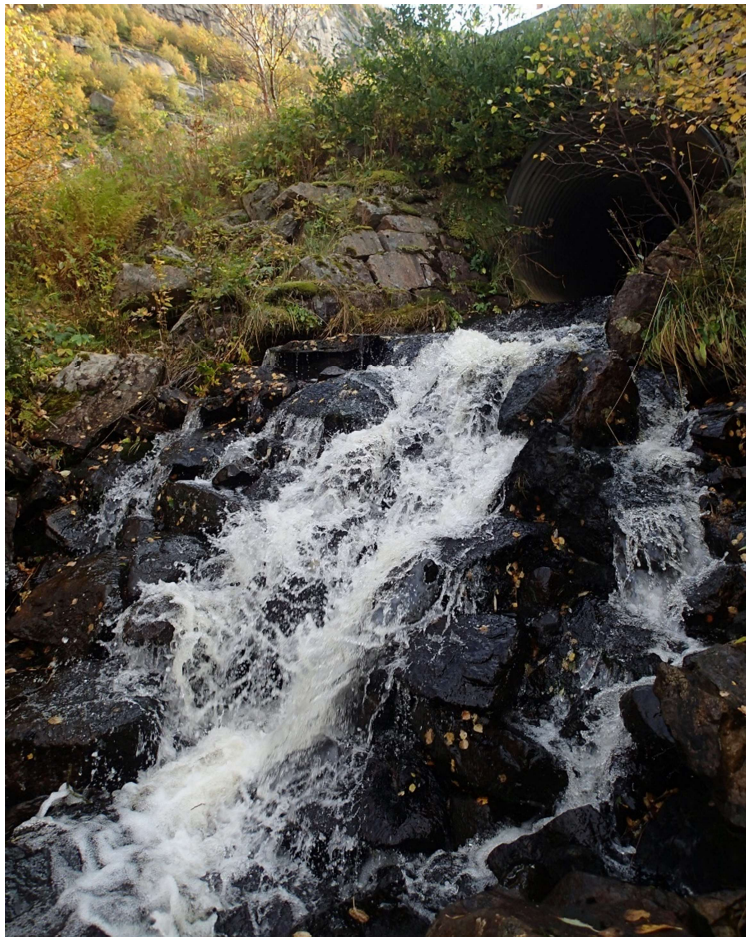
Figur 16 En terskel nedstrøms dagens fylkesvei utgjør vandringshinder for anadrom fisk i Fjordabekken.
