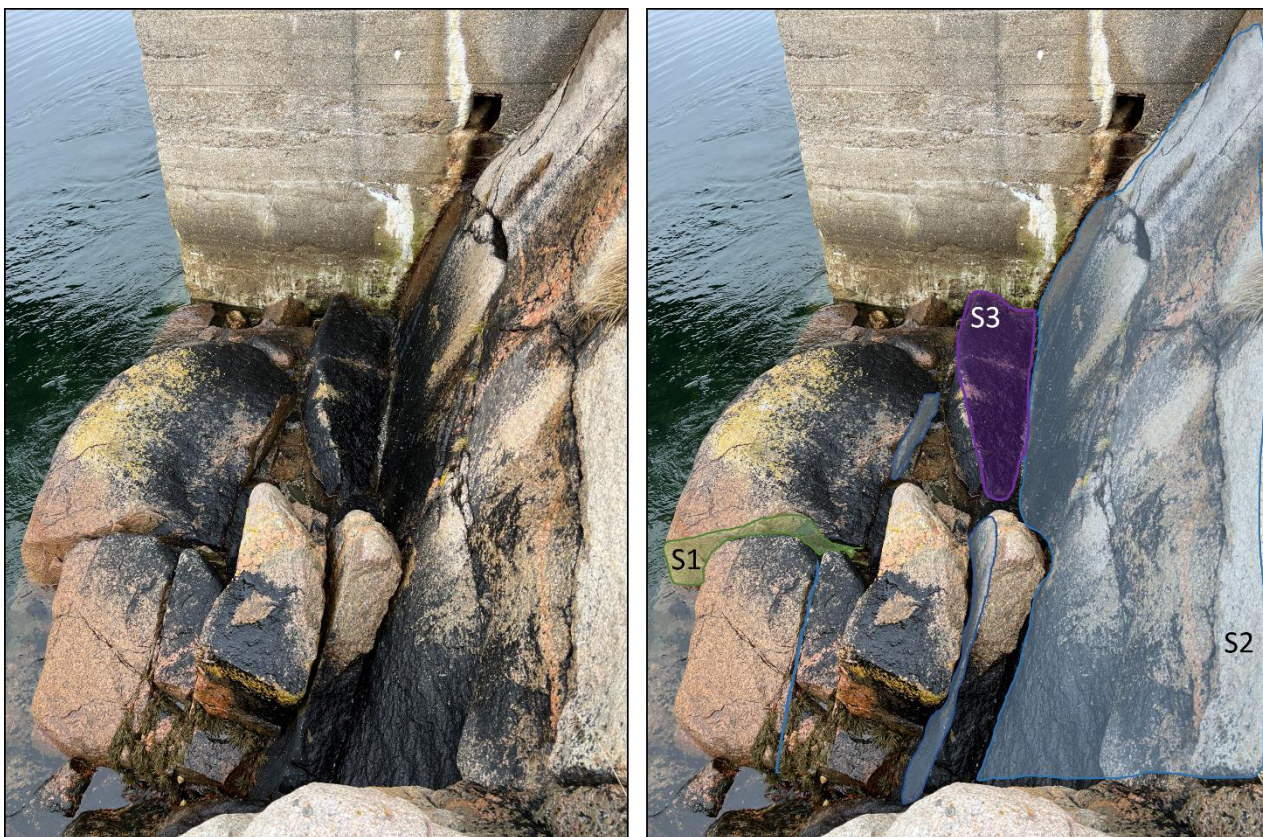
Figur 21: Sprekkesett S1, S2 og S3 ved fundamentområdet, nært eksisterende/gammelt brufundament. Uten hjelpelinjer (venstre), med hjelpelinjer (høyre).
