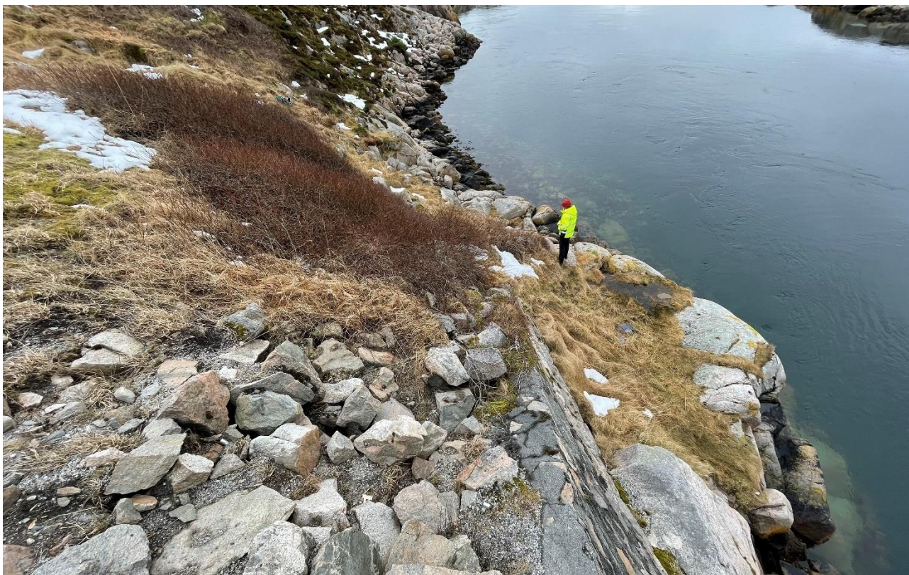
Figur 10: Fyllmasser bak mur (trolig sprengstein i topp) og buskas i skråningen ned mot sjøen. Bilde tatt mot sørvest.
