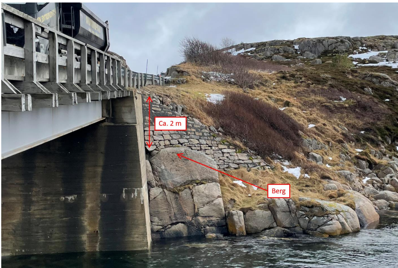
Figur 4.10: Foto fra Kvernøystraumen sør, dato 2023-03-23 kl. 13:22. Vannstand ca. +1,0 m (NN2000). Det er vingemur ved siden av eksisterende landkar med største høyde 1,5-2,0 m. Dvs. at største løsmassetykkelse (løsmasse antas samfengt stein) er tilsvarende 1,5-2,0 m. Bergoverflaten skrår generelt bratt fra strandkant og innover i bildet. Det er synlig berg på alle kanter av broen.
