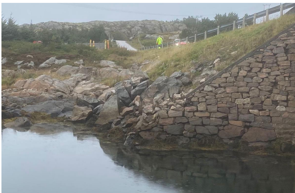
Figur 4.4: Bildet tatt dato 2022-09-13, ca. kl. 1050. Vannstand på bildet er ca. -0,3 m (NN2000). Fundamenteringsnivå brolandkar foreløpig planlagt kote +0,5 m.
