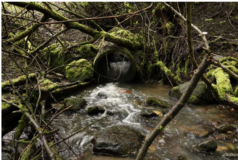
Figur 4-28 Situasjonsfoto utløp fra fylling, med en liten rørstubb
