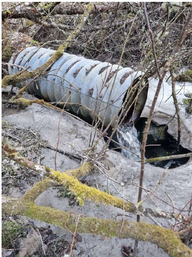
Figur 4-22 Rør i bekken
