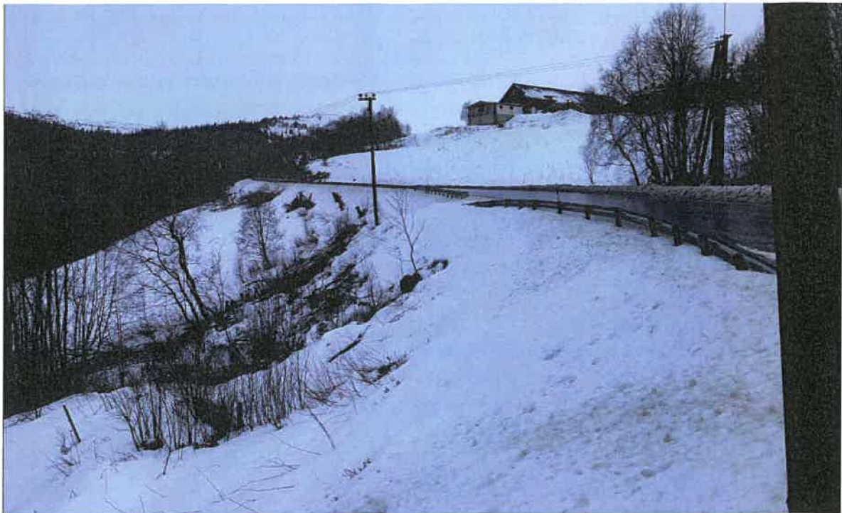
Figur 4: Foto, tiltak 1. Vi ser utløp av stikkrenne (plast Dim800mm) midt i bildet.
