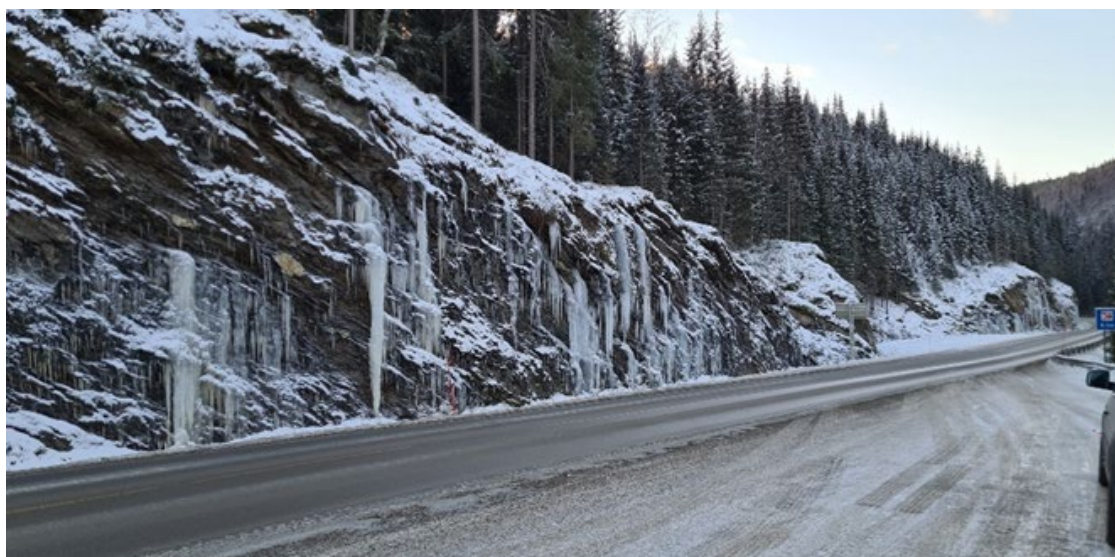
Figur 11: Dagens Fv. 30 ligger nær bratte fjellskjæringer som er svært rasutsatt. (Foto: Asgeir Gylland)
