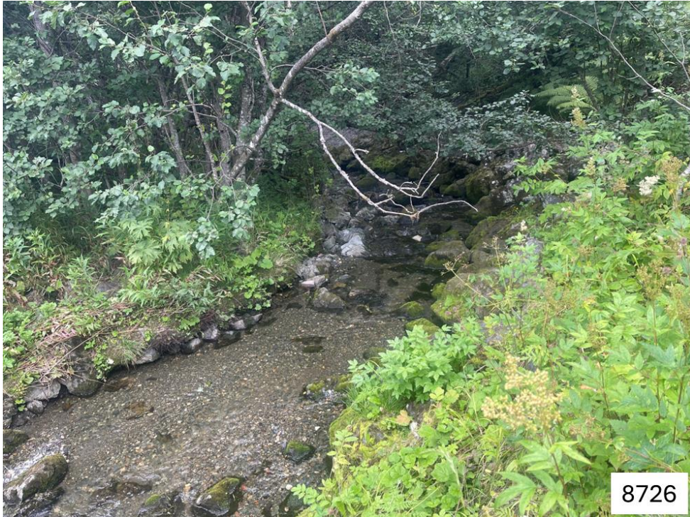
Figur 11: Område 5, Heimdalsbekken. Bilde nr. 8726 er tatt mot nord fra utløp av kulvert. Viser grus/stein i bekkeleiet og større steiner/stablemur i yttersving.
